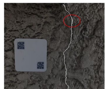
③クラックを合成 ※外壁のどの部分が最大幅であるかが判明します。
